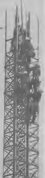
Technikern gelang es, eine Stromleitung bis zum AKW zu führen. REUTERS
